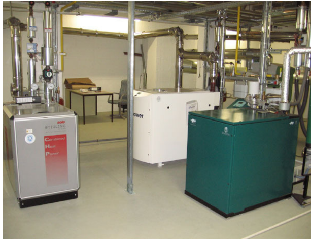
Abb. 9: Neue Mini-BHKW's in den Gewerbeschulen
