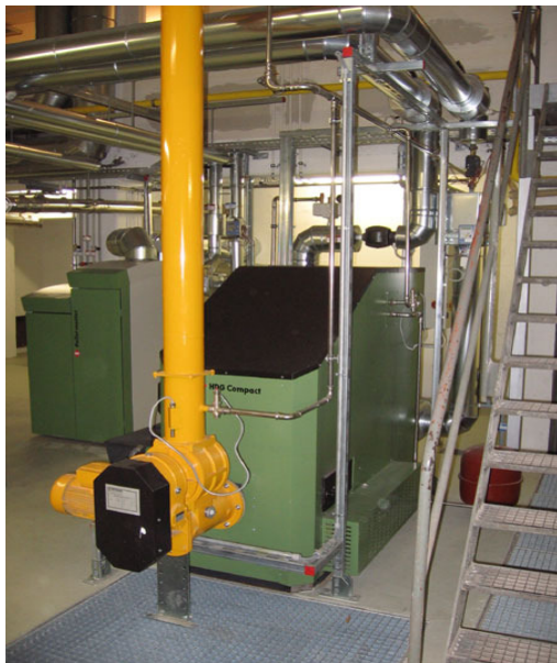
Abb. 10: Neue Holzpelletanlage in den Gewerbeschulen
