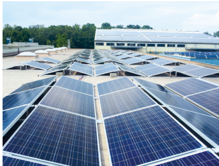
Auf Eigenverbrauch ausgelegte PV-Anlage der Firma Feinkost Zahner in Freiburg (Bild: Badische Energiesysteme GmbH)
