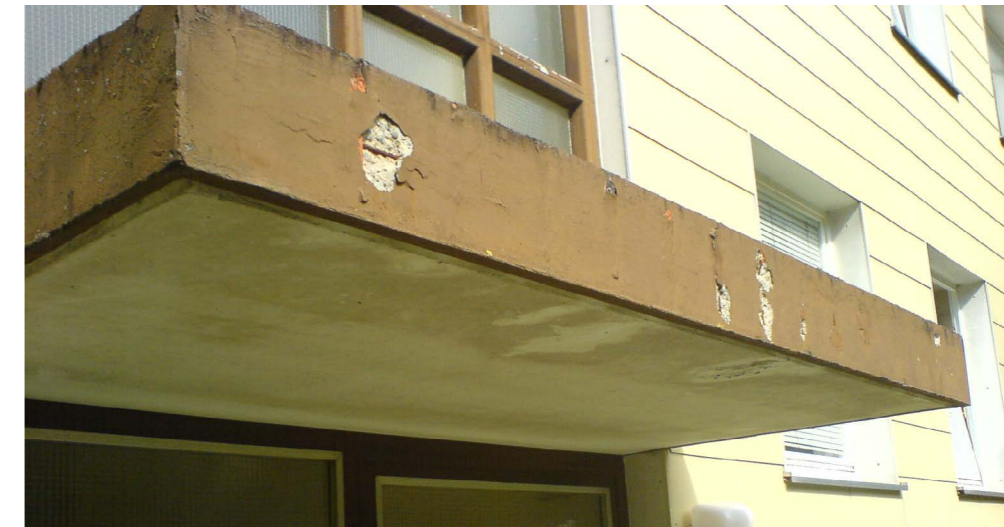
Abbildung 6: Betonschaden an einem Vordach
