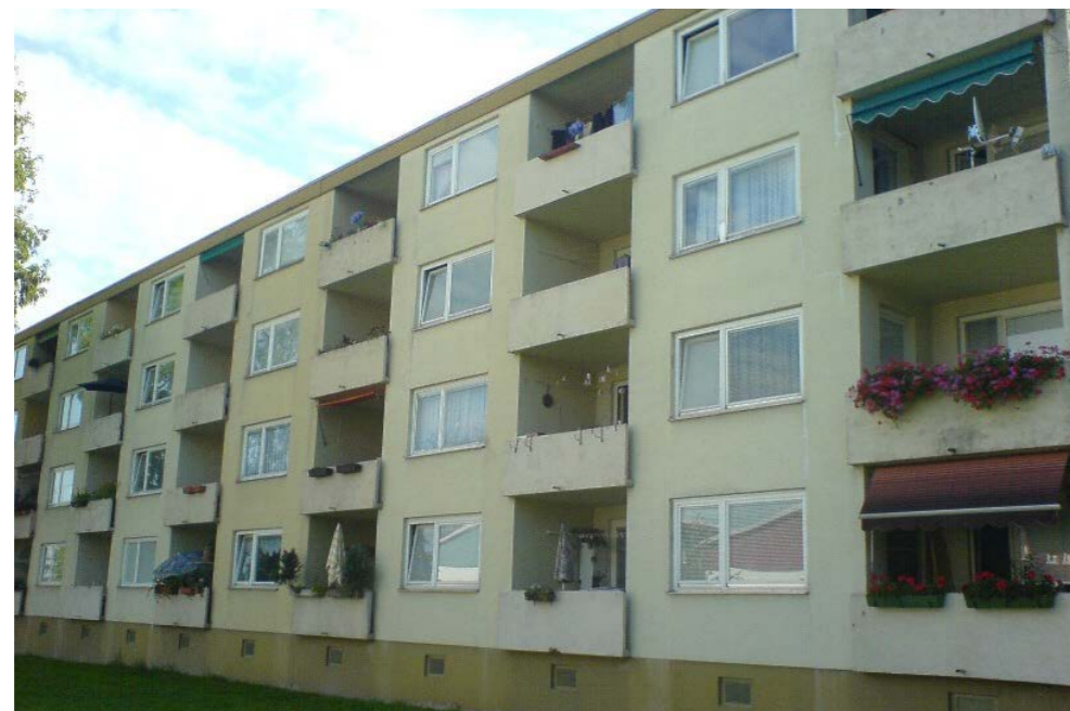
Abbildung 5: Sanierungsbedürftige und triste Fassade des Gebäudes Binzengrün 11-15
