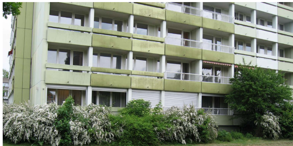
Abbildung 3: Veraltete Fassadengestaltung der Bugginger Straße 50
