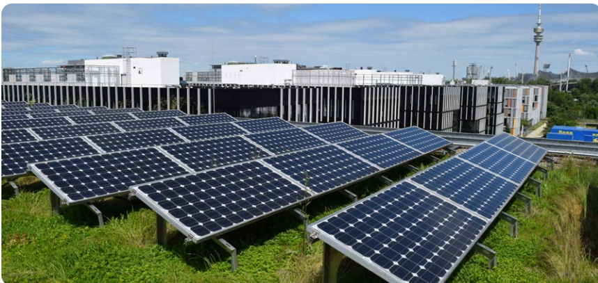
Ein Solar-Gründach in München: Dank speziell ausgesuchter, kleinwüchsiger Pflanzen werden die Photovoltaik-Module nicht verschattet.
