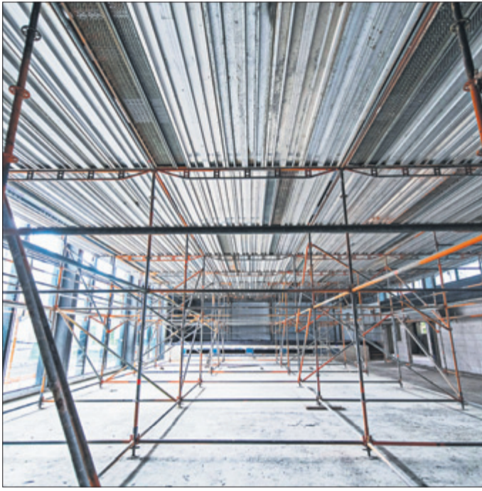
Mehr als Rohbau: Unter dem Gerüst ist die Deckenkonstruktion schon fast fertig. Im Frühjahr sollen in der Dreisamhalle wieder Veranstaltungen und Schulsport stattfinden. (Foto: P. Seeger)
