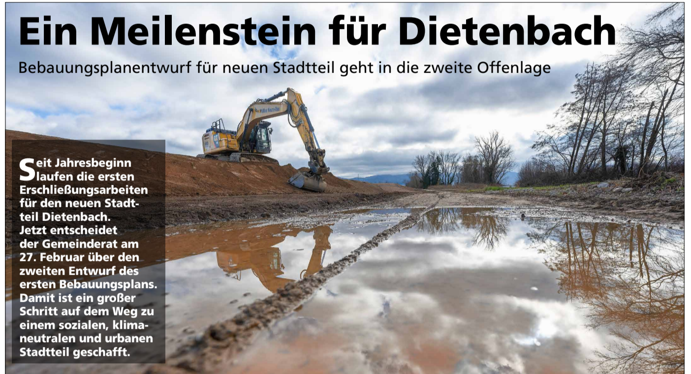
Kurz vor dem Start: Die ersten Erschließungsarbeiten in Dietenbach haben begonnen, der Spatenstich steht bevor.
