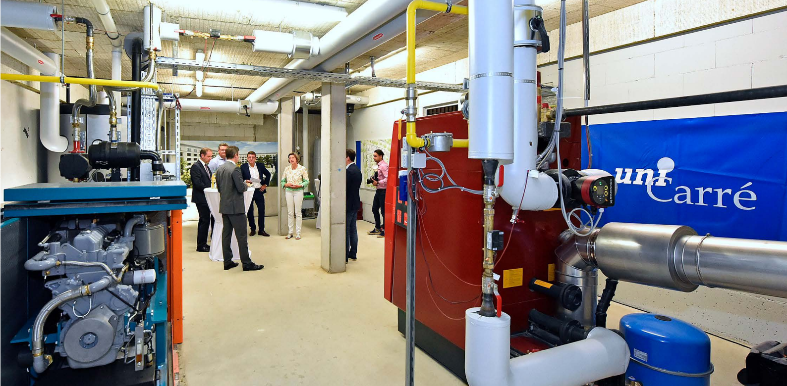
Blockheizkraftwerk im Uni-Carré
