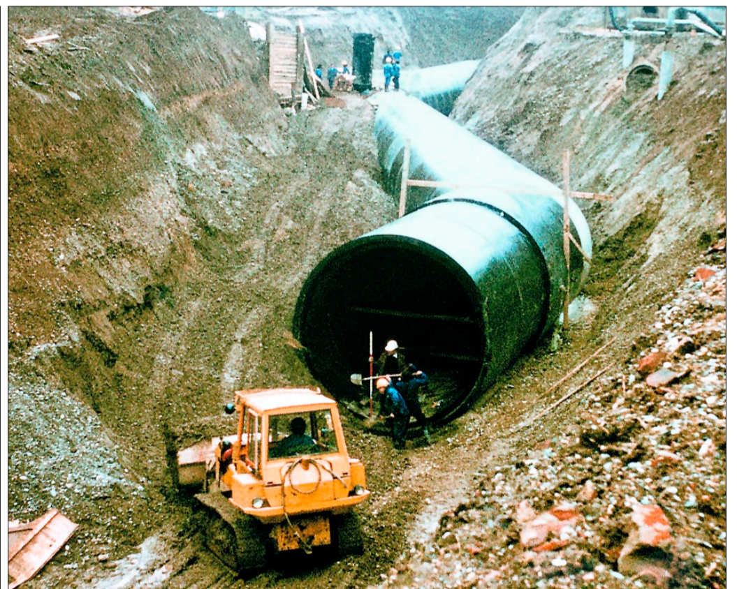
Das Bild aus der Bauzeit in den 70er-Jahren zeigt einen Teil des heute unsichtbaren, gewaltigen Kanalnetzes mit bis zu vier Meter dicken Rohren. (Foto: AZV)
