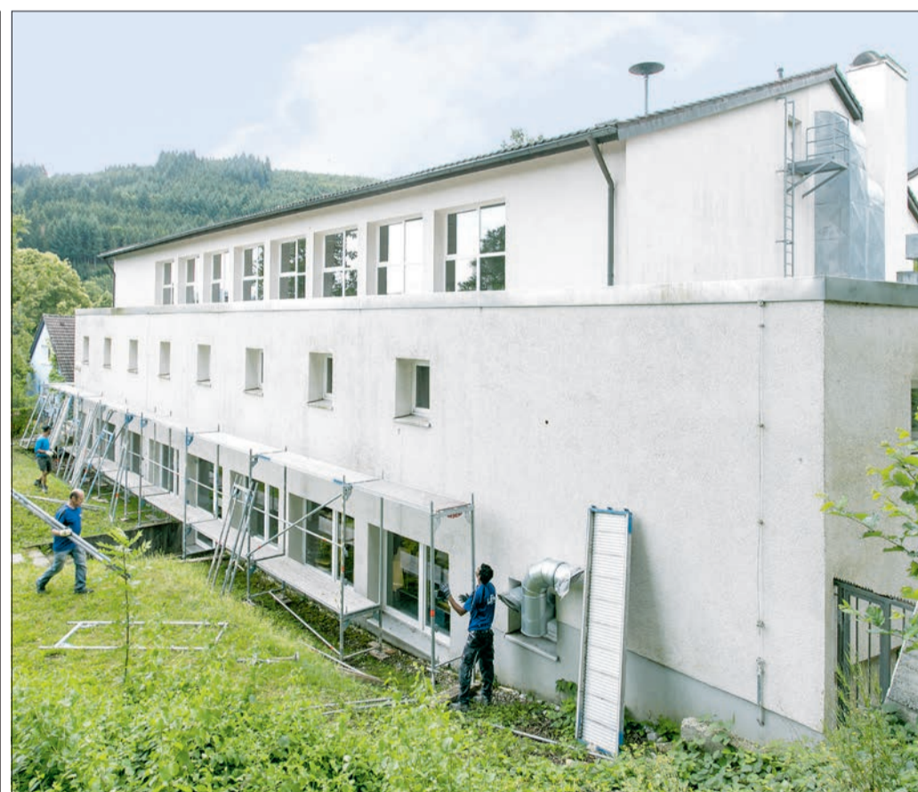
Bei der Schauinslandschule in Kappel ist das Flachdach des Verbindungsbaus undicht. Für die Sanierung braucht es erstmal ein Gerüst. (Foto: A. J. Schmidt)
