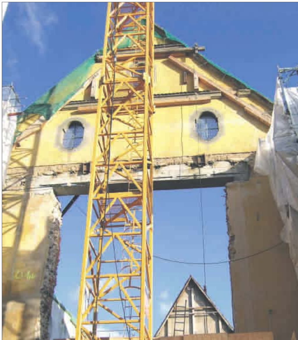
Dach ab: Zum Umbau des Augustinermuseums wird der Dachstuhl abgenommen. Das macht zwar die Arbeit leichter, bringt aber auch bislang unentdeckte Schäden ans Tageslicht. Der Gemeinderat stellt die erforderlichen Mittel von 1,7 Millionen Euro bereit. (Foto: R. Buhl)
