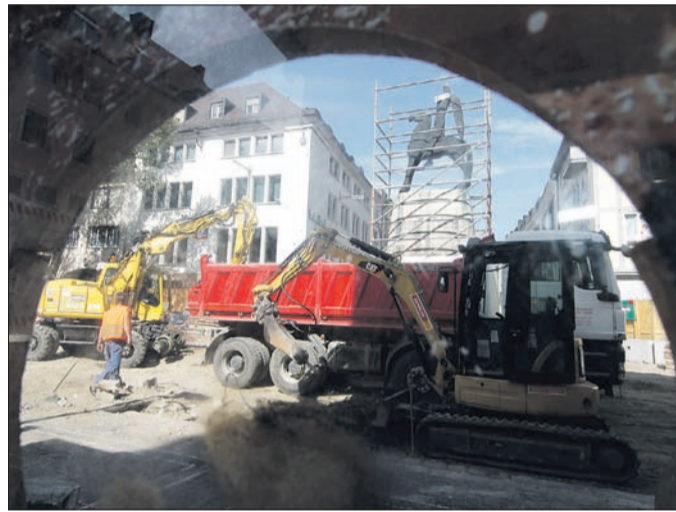
Hinter Gittern: Ritter B. überstand die Baustelle am Bertoldsbrunnen schadlos. (Foto: A. J. Schmidt)
