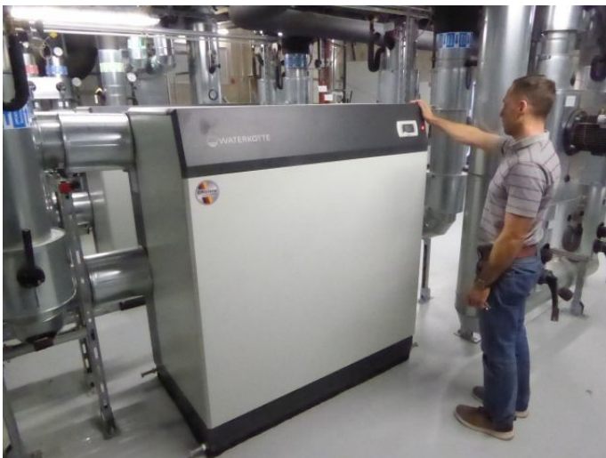
Abb. 9: Kontrolle einer der beiden Wärmepumpen im neuen Rathaus im Stühlinger (RIS)
