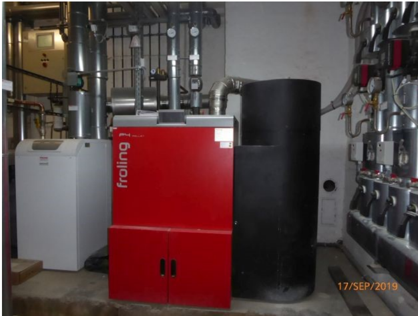
Abb. 21: Neue Holzpellet-Anlage (rot) mit Spitzenlastkessel (weiß) und Pufferspeicher (schwarz) in der Mooswaldschule
