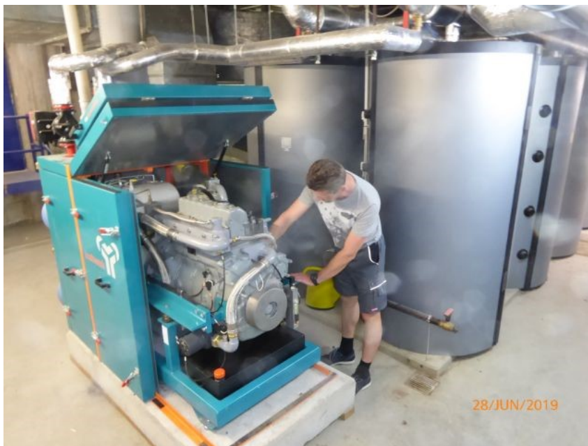
Abb. 23: BHKW Deutsch-Französischen-Gymnasium (Begutachtung BHKW-Aggregat, Heizwasserspeicher hinten)
