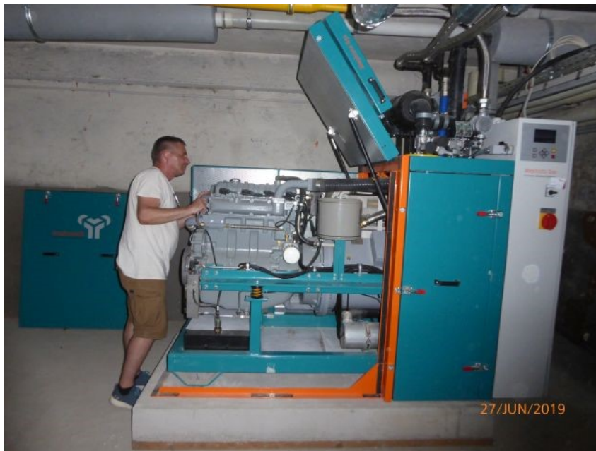
Abb. 24: Städtisches BHKW Nahwärmeprojekt Pestalozzischule (Schallschutz geöffnet)
