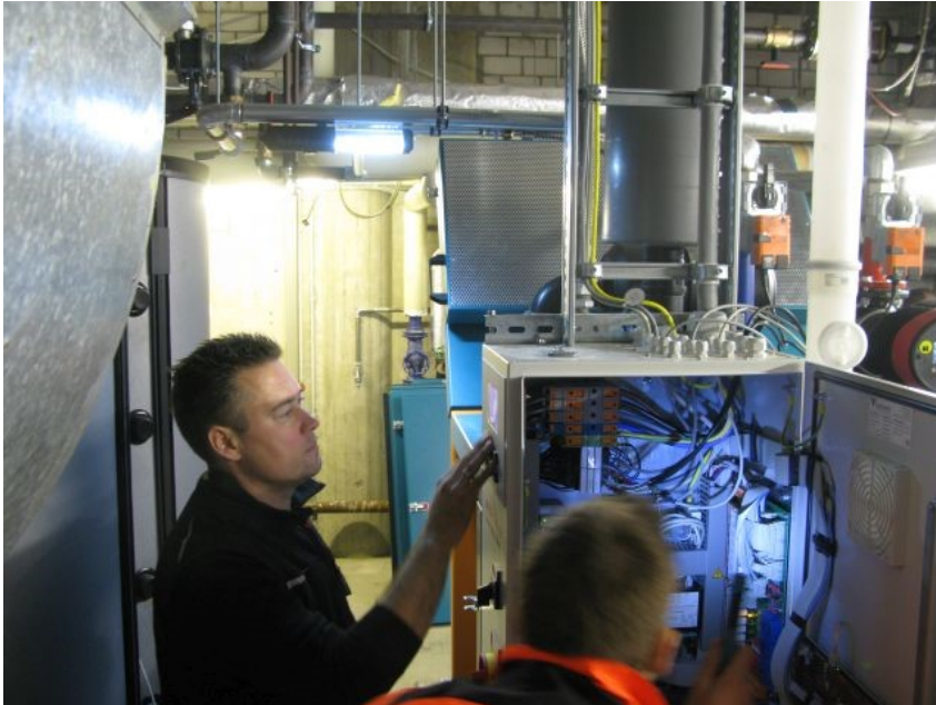
Abb. 22: Inbetriebnahme BHKW 50 kW el , Deutsch-Französisches-Gymnasium (DFG)
