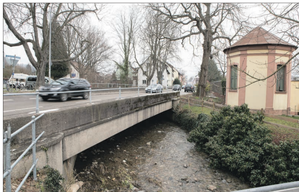
Am Ende: Die Eschbachbrücke in Ebnet ist so marode, dass sie komplett erneuert werden muss. Dazu muss die Schwarzwaldstraße rund ein dreiviertel Jahr voll gesperrt werden. Der Verkehr aus dem und ins Dreisamtal wird großräumig umgeleitet. (Foto: A. J. Schmidt)
