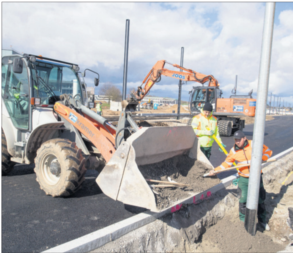
Ende in Sicht: Die Großbaustelle rund ums neue Stadion (im Hintergrund unterm Baggerarm zu sehen) befindet sich schon fast auf der Zielgeraden – im Juli sind die Straßen fertig, im Oktober dann auch die Stadtbahn. Doch auch danach wird im Stadtgebiet fleißig gebaut. (Foto: A. J. Schmidt)
