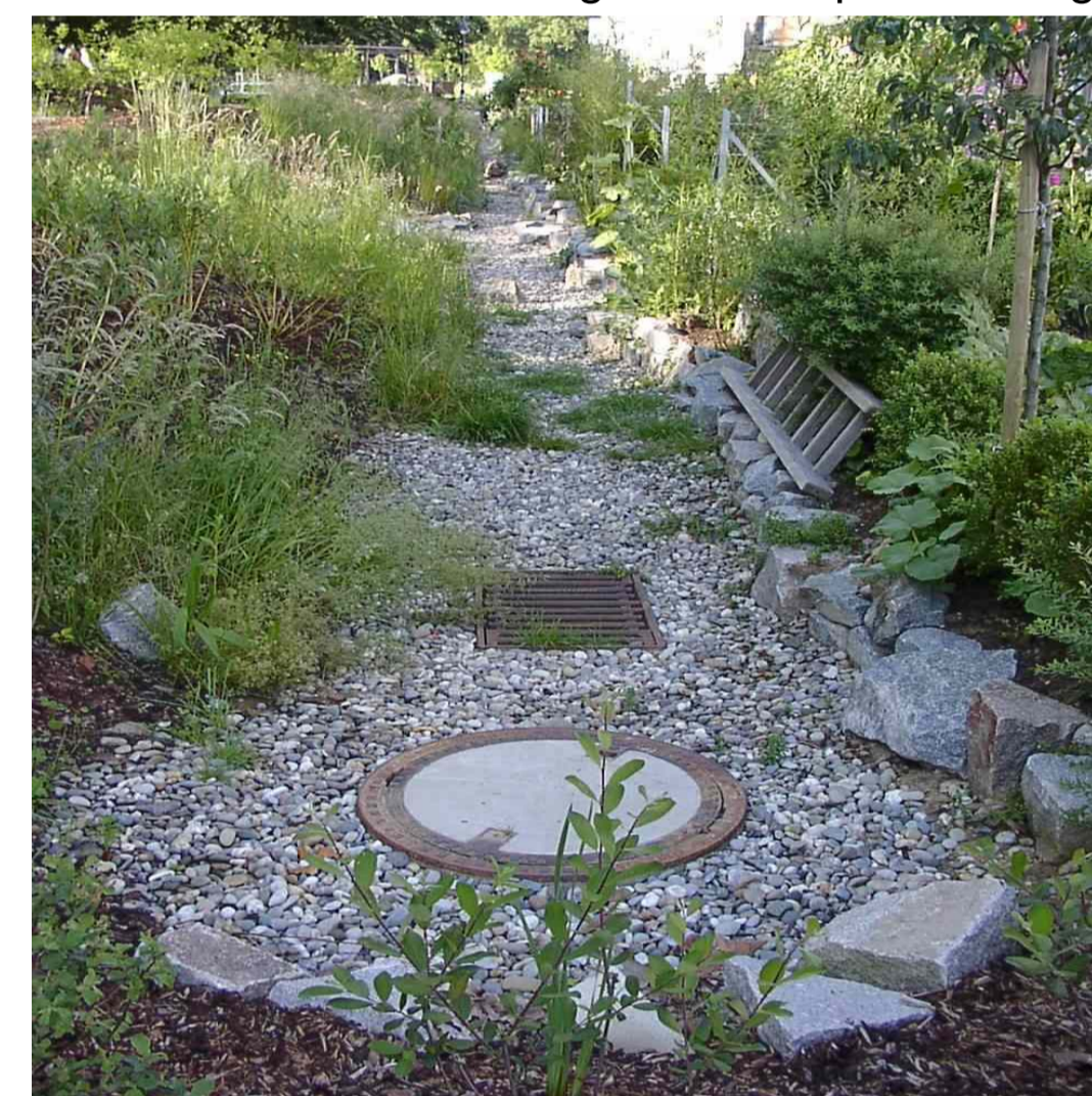
Versickerungsfläche - Infiltration field
